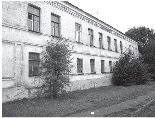
Деревья растут из-под стен на ул. Дзержинского, 11 и разрушают здание
